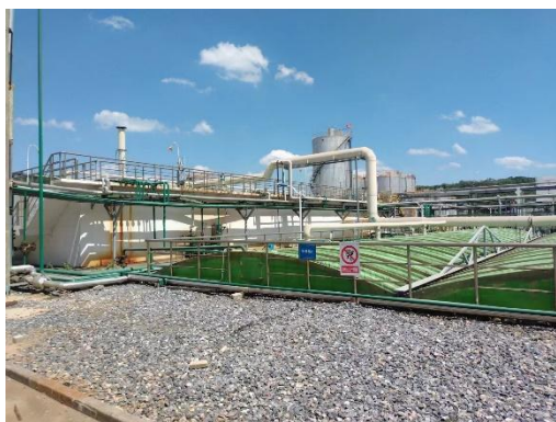
北厂区生化污水处理
